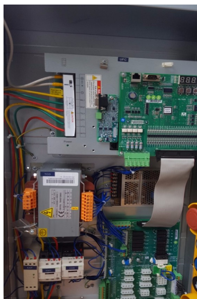
Tủ điều khiển: Fuji - Thailand
