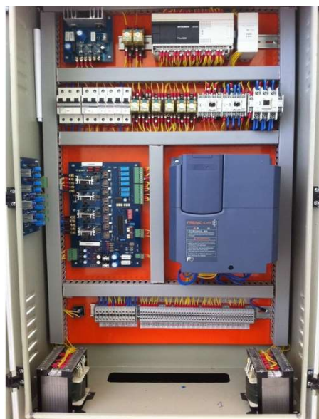
Tủ điều khiển sử dụng: biến tần - PLC
